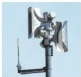
Beim Zivildienst-Probealarm werden die Sirenen auch auf ihre Funktionstüchtigkeit geprüft. Foto: Lang-Hell
